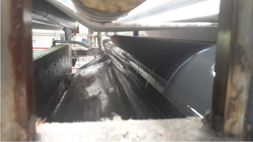
Boşaltılarak Temizlenmiş Aprenin alt kısmındaki Tutkalı Boşaltma Borusu ve Vanası
