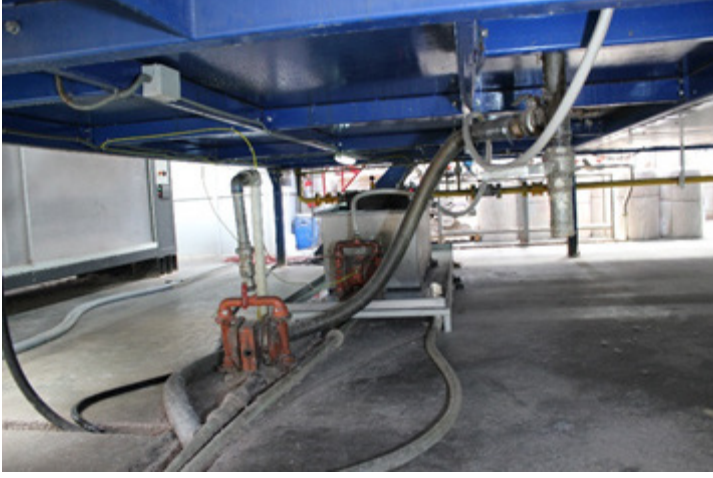
Aprenin alt kısmındaki Tutkalı Boşaltma Borusu ve Vanası
