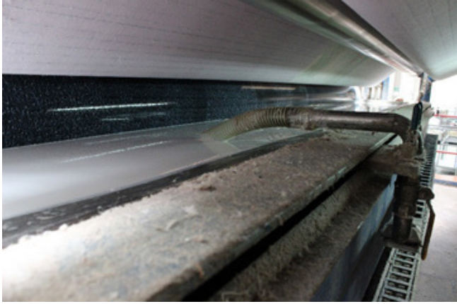
Apre Teknesindeki Fazla Tutkal Tahliye Borusu
