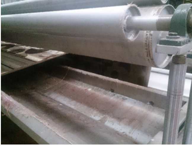
Apre Teknesindeki Fazla Tutkal Tahliye Borusu
