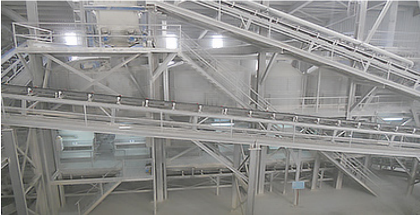
Şekil 3 Manyezit Cevheri Cevher Hazırlama Tesisi Manyetik Ayırıcılar ve Siloları (URL-8)
