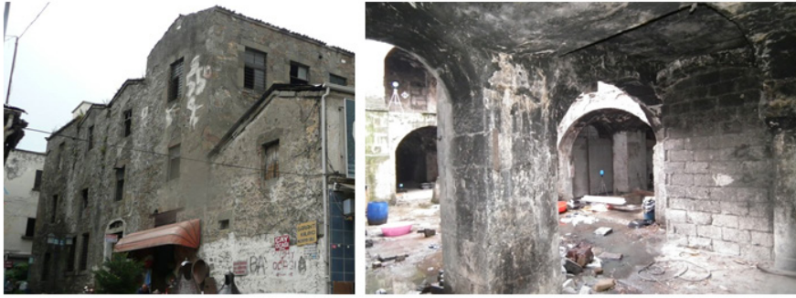
Resim 9. Alaca Han'ın restorasyon çalışmalarından önce kuzey cephesinde genişletilerek kapıya çevrilen pencerelerinden (solda) ve zemin kat revaklarına örülen tuğla duvarlarından (sağda) görünüm (Trabzon KVKK Arşivi, 2004).
