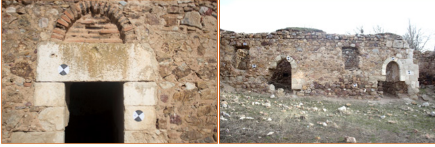
Şekil 14. Doğu ve batı cephelerde odaların giriş kapısı üzerindeki tuğla kemerlerin düşen kaplama taşları ile güney cephedeki odaların giriş kapılarının kenar ve kemer taşlarındaki malzeme kayıplarının görüntüsü
