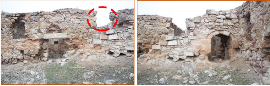
Şekil 19. Avluya eklenmiş merdivenin basamaklarından dolayı 5 numaralı odanın pencere yüksekliğini kaybetmesi ve 5 numaralı odanın girişinin uzandığı merdiven altına yapılmış üzeri tonozlu geçidin görünüşü
