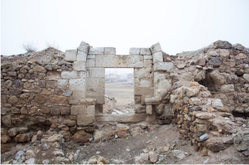
Şekil 13. Ahır holünden eyvana açılan giriş kapısının üst kemerindeki hasarın görünüşü
