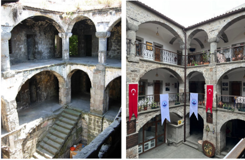
Resim 12. Alaca Han'ın avlusunun, sonradan eklenen betonarme merdivenin bulunduğu halinden (solda) ve restorasyondan sonra bu merdivenin temizlendiği (sağda) halinden görüntüleri (Engin, 2023).
