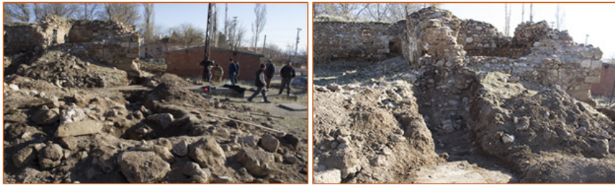
Şekil 16. Yapının kuzeybatı cephesinde 2, 3 ve 7 numaralı açmalarda yapılan kazılarda ortaya çıkartılan odalara ait temel ve duvar kalıntılarının görünüşü
