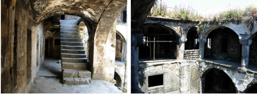
Resim 10. Alaca Han'ın restorasyon çalışmalarından önce ikinci kat revaklarına eklenen betonarme merdiven (solda) ile ikinci kat revaklarının avluya bakan yönünde örülen duvardan (sağda) görünüm (Engin, 2023).
