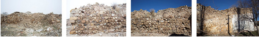
Şekil 53. Soldan sağa doğru; ılıca odalarının batı cephesinde yıkılmış durumda olan dış duvarının görünüşü, ılıca odasının batı cephe dış duvarı görünüşü, konaklama odaları (spa) batı cephe dış duvarının görünüşü, ahır bölümü (lobi) duvarının batı cephe dış görünüşü
