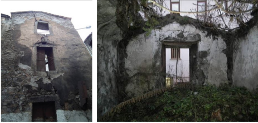
Resim 10. Alaca Han'ın restorasyon çalışmalarından önce yıkılmak üzere olan doğu cephesinden (solda) üst örtüsü yıkılan odasından (sağda) görünümler (Trabzon KVKK Arşivi, 2004).
