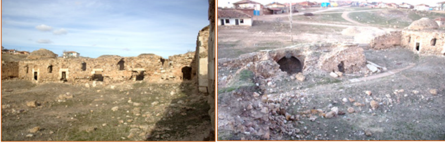
Şekil 11. 1 numaralı odanın mevcut kubbesi ile diğer konaklama odaları tonozlarının ve ılıca odaları kubbelerinin yıkık halinin görünüşü
