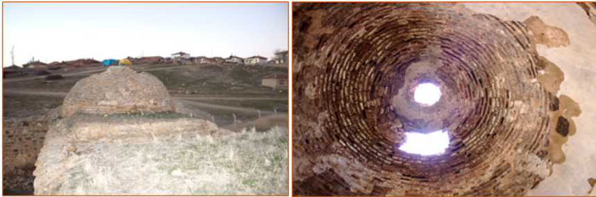
Şekil 12. Kuzeydoğuda yer alan odanın mevcut kubbesi ile hasarlarının iç mekandan görünüşü
