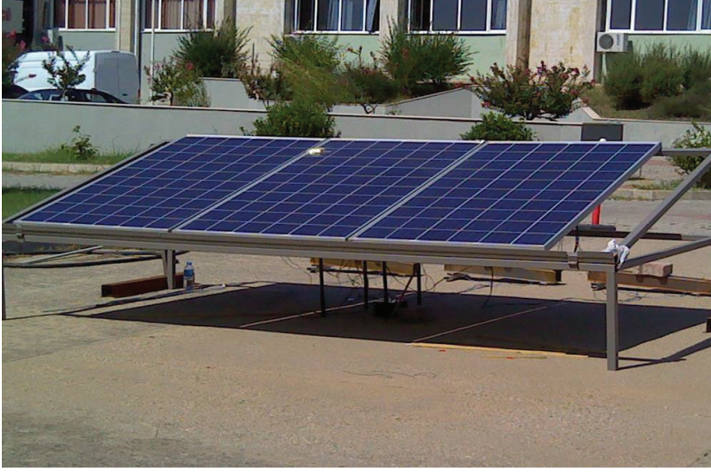
Şekil 3:Fotovoltaik Sistem Kurulumu
