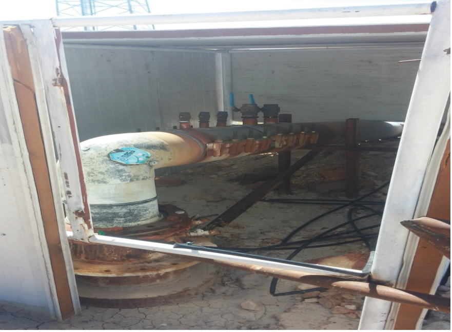
Şekil 4: Kozaklı merkezi ısıtma sistemi reenjeksiyon kuyusu
