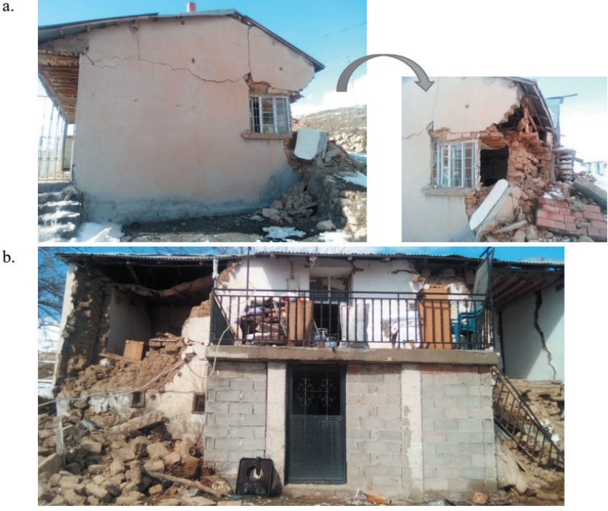
Şekil 16. Düzlem dışı davranışa bağlı yapısal hasarlar
