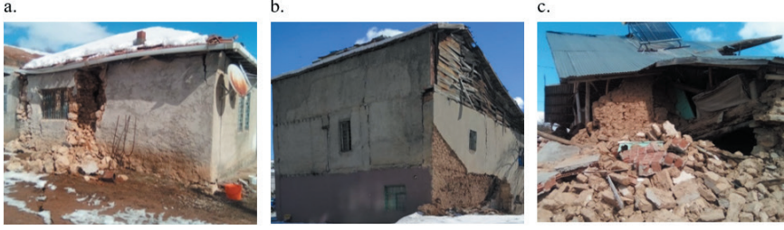
Şekil 17. Malzeme özelliklerine bağlı yapısal hasarlar
