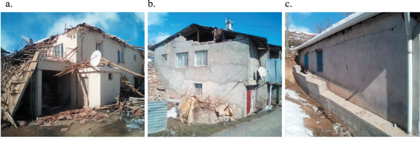
Şekil 25. Yetersiz çatı-duvar bağlantısına bağlı yapısal hasarlar
