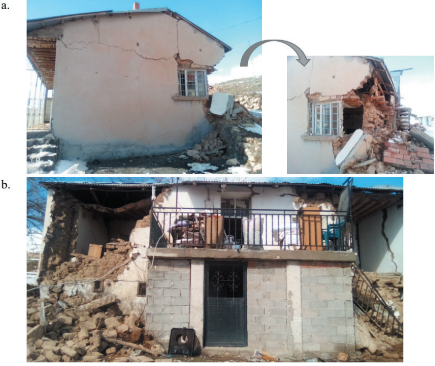
Şekil 16. Düzlem dışı davranışa bağlı yapısal hasarlar
