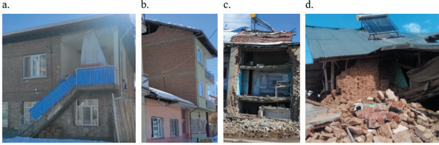
Şekil 11. Mevcut yapılarda hasar seviyeleri (a) hasarsız yapı (b) az hasarlı yapı (c) ağır hasarlı yapı (d) yıkık yapı
