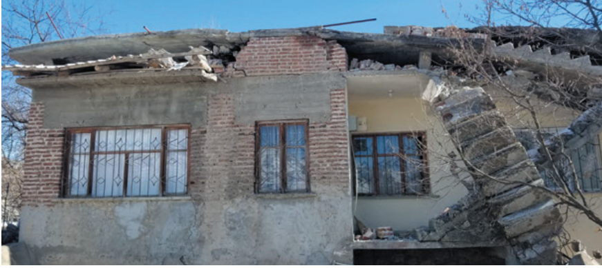
Şekil 24. Uygun olmayan boyutsal eleman (çatı sistemi) özelliklerine bağlı yapısal hasarlar
