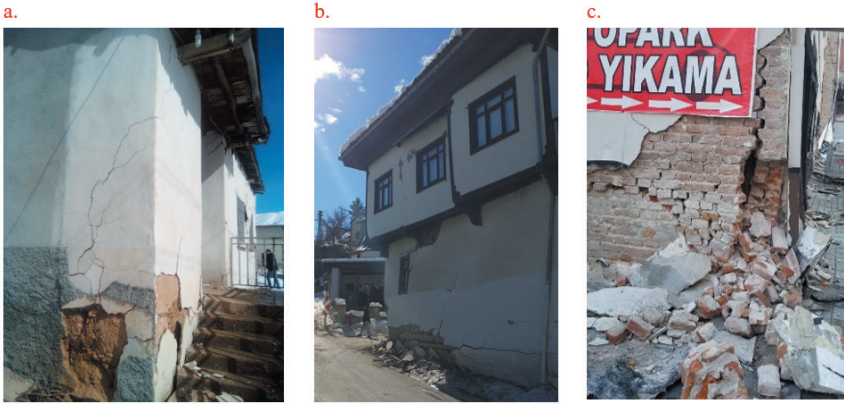
Şekil 15. Tabanda ezilmeye bağlı yapısal hasarlar
