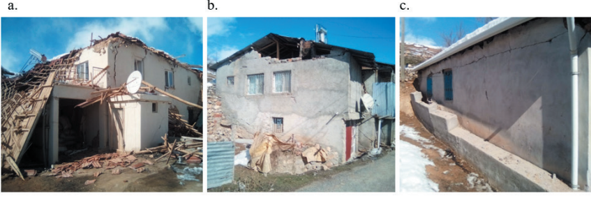
Şekil 25. Yetersiz çatı-duvar bağlantısına bağlı yapısal hasarlar
