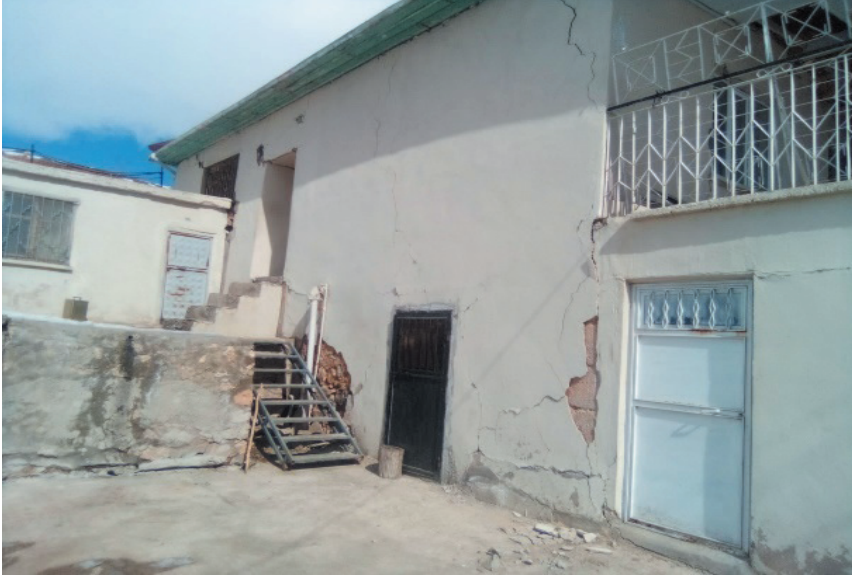
Şekil 23. Uygun olmayan boyutsal eleman (duvar sistemi) özelliklerine bağlı yapısal hasarlar
