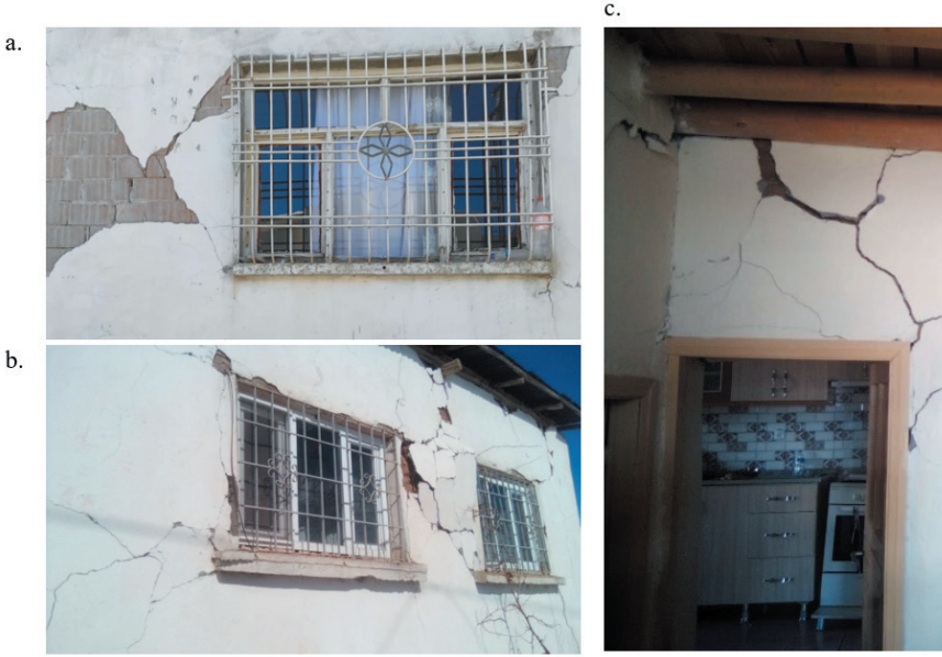
Şekil 20. Kapı pencere boşluğu kesme çatlağına bağlı yapısal hasarlar
