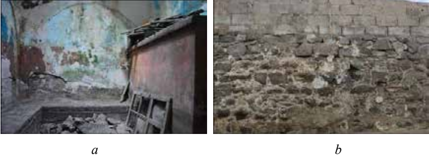
Şekil 23. Deva Hamamı iç ve dış duvarlarında oluşan nem, tuzlanma
