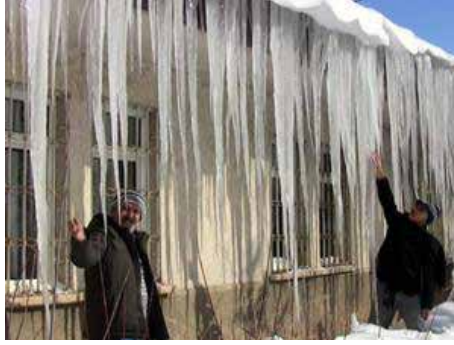
Şekil 6: Saçakta Oluşan Buz Sarkıtı (“Erzurum Ajans,” 2018)
