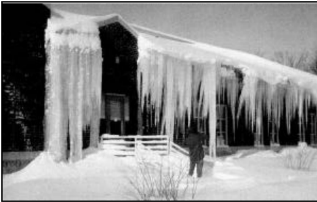
Şekil 14: Çatılarda Oluşan Buz Sarkıtlarına Örnek (Buska & Tobiasson, 2001: 344)
