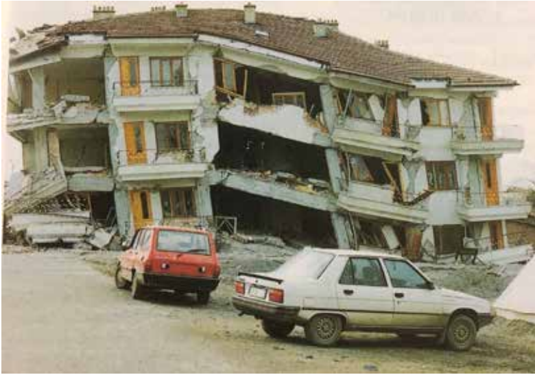
Resim 3 Bina Hasarları (Çuhadaroğlu, F. ve diğerleri, 1992, s.51)
