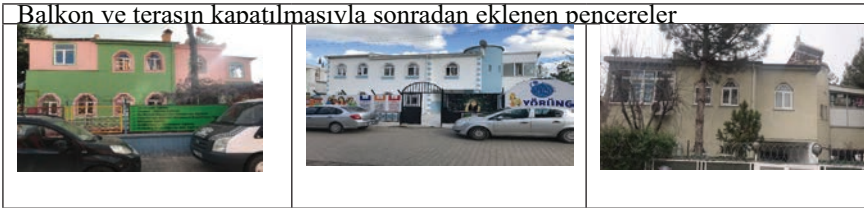
Şekil 18. Balkon ve terasın kapatılmasıyla sonradan eklenen pencereler
