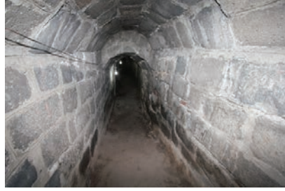
Fotoğraf: 24- Sarayın Kaçış Tünelinin İçten Görünüşü.
