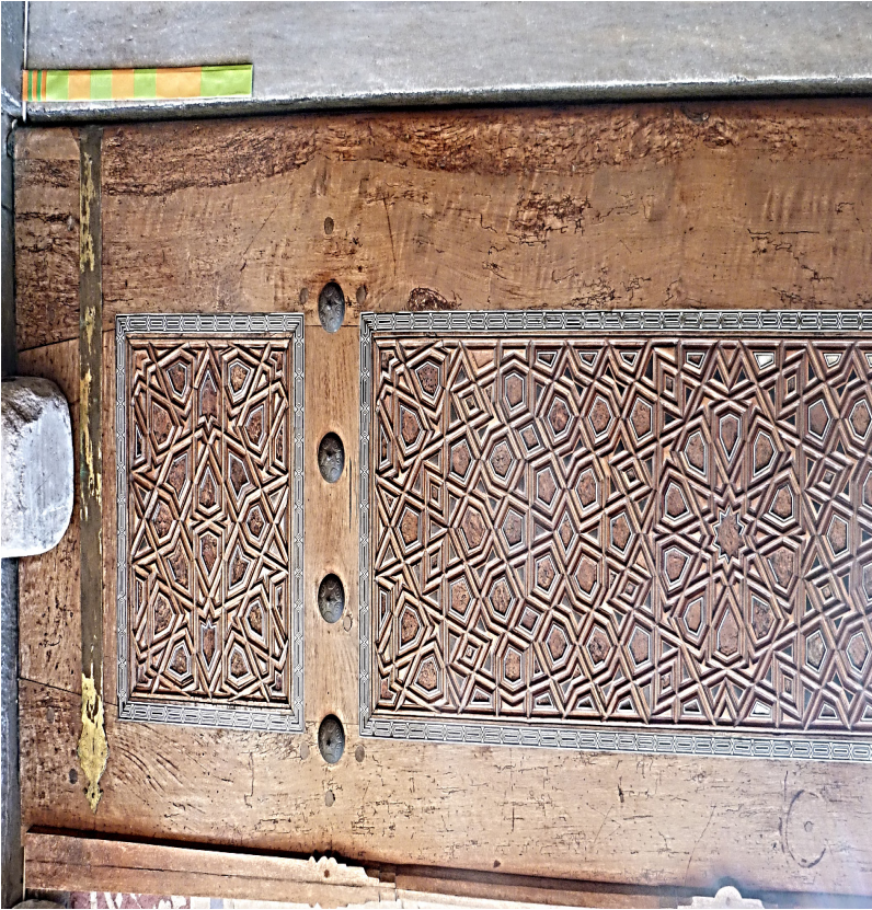
Resim 27. Mihrab duvarındaki sedefli künde-kârî pencere kapaklarındaki sedef işlerinde sedefleri dökülmüş alanlar.
